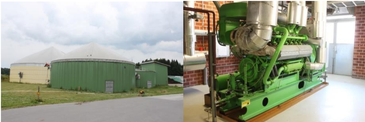
Slika23. Digestori (levo) i CHP jedinica (desno) biogasnog postrojenja (Izvor: RutzD.)
