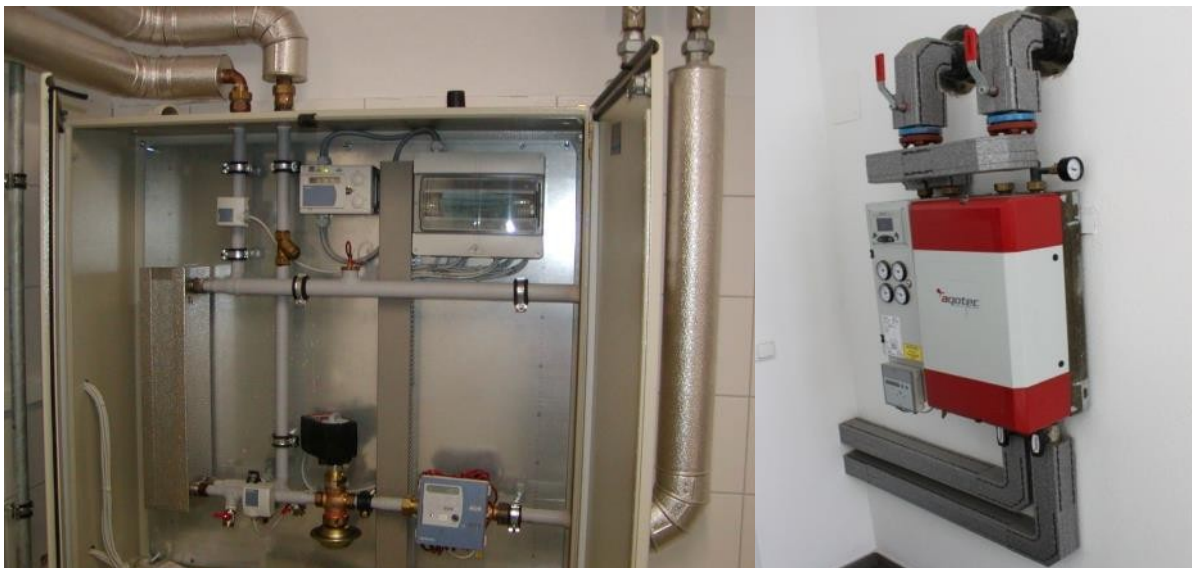
Slika55. Toplotna podstanica sa izmenjivačem toplote, regulacionim uređajem, ventilima i kalorimetrom (levo) (Izvor:Güssing Energy Technologies) i toplotna podstanica (uključujući izmenjivač toplote) krajnjeg potrošača u Achentalu, Nemačka (Izvor: Rutz D.)
