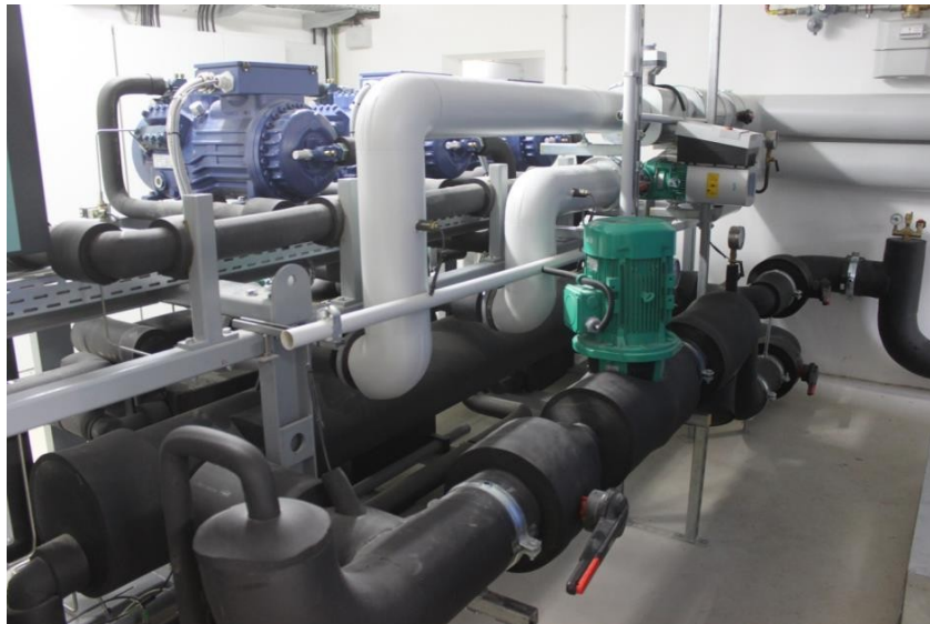
Slika 23. Toplotna pumpa koja koristi podzemne vode kao izvor toplote (instalirana snaga 440 kW) u malom SDG sa solarnim kolektorima u Dollnsteinu, Nemačka (Izvor: Rutz D.)
