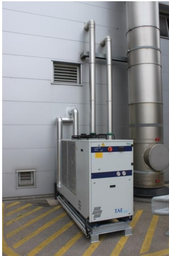
Slika 54. Rashladni uređaj hlađen vazduhom koji koristi otpadnu toplotu postrojenja za spaljivanje otpada u Austriji (Izvor: Rutz D.)
