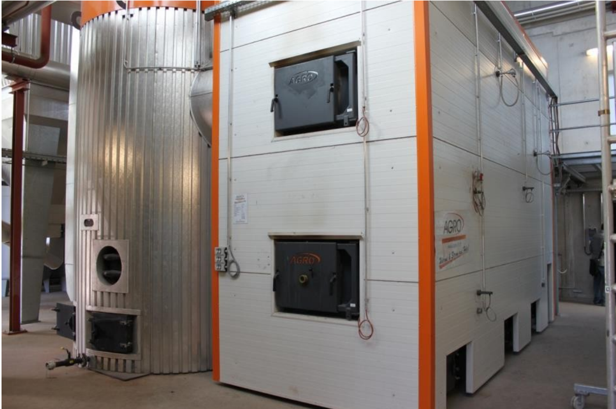
Slika 11. Sistem grejanja srednje snage (instalirana snaga 3 000 kW) sa kotlom (desno) i skladištem toplote (levo) u Nemačkoj - Biomassehof Achental (Izvor: Rutz D.)
